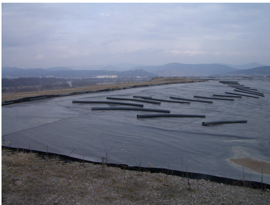
Obr. 5.7: Pokrývanie temena haldy nepriepustnou fóliou. Na povrchu drenážne rúry pripravené na montáž
